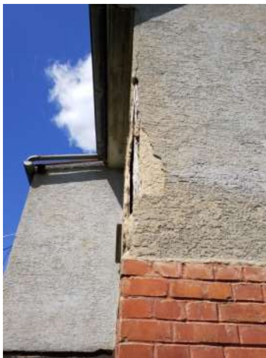
Abb. 9: Spalten hinter Mauerputz an der Westseite des Wohngebäudes Hindenburgstraße 47.
