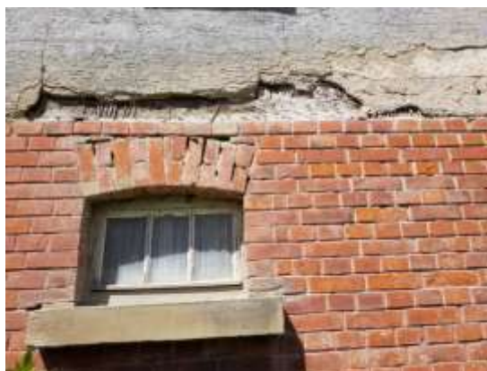
Abb. 11: Spaltenöffnungen (Detail) hinter Putz und im Mauerwerk an der Südseite des Wohngebäudes Hindenburgstraße 47.
