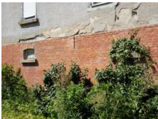
Abb. 10: Spaltenöffnungen hinter Putz und im Mauerwerk an der Südseite des Wohngebäudes Hindenburgstraße 47.
